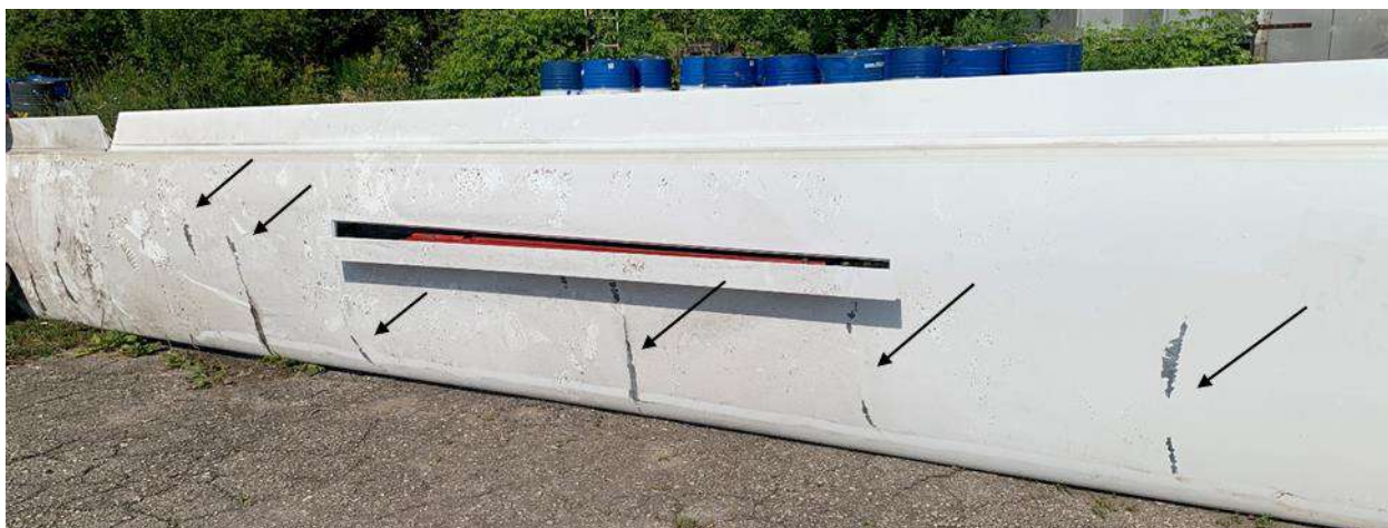
Рис. 17. Следы отслоения ЛКП
